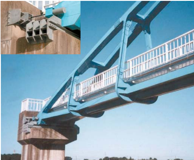
水管橋（支圧型）
